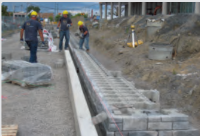
Poursuite de la pose des blocs stabilisateurs. Une fondation à niveau et des blocs bien alignés permettent une construction rapide des rangs subséquents sans repositionnement important des éléments déjà en place
