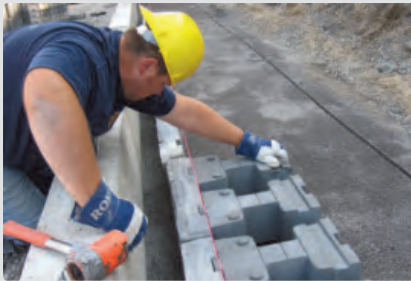
Mise en place des premiers stabilisateurs et des facias parfaitement alignés à l'aide d'un cordeau tendu
